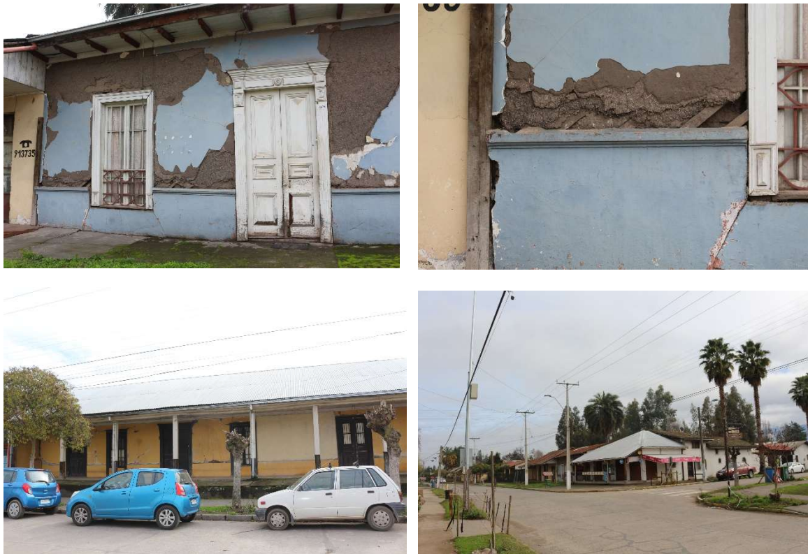
Figura 16: Deterioro de edificaciones por falta de mantención y por intervenciones no acordes al sistema estructural.
