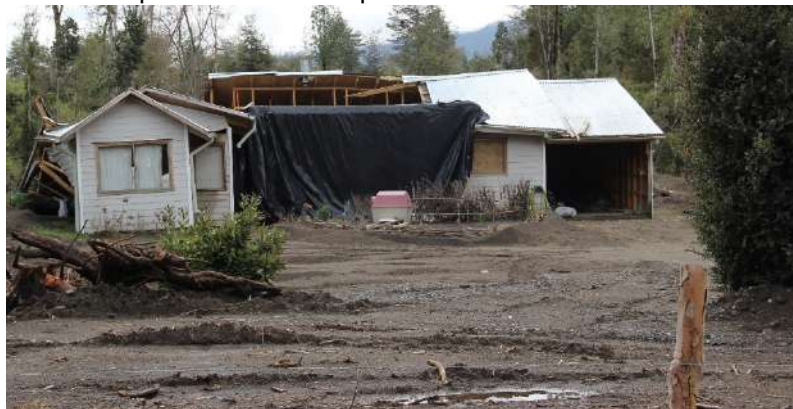
Figura 32. Colapso de techumbre por caída de cenizas – localidad de Ensenada
