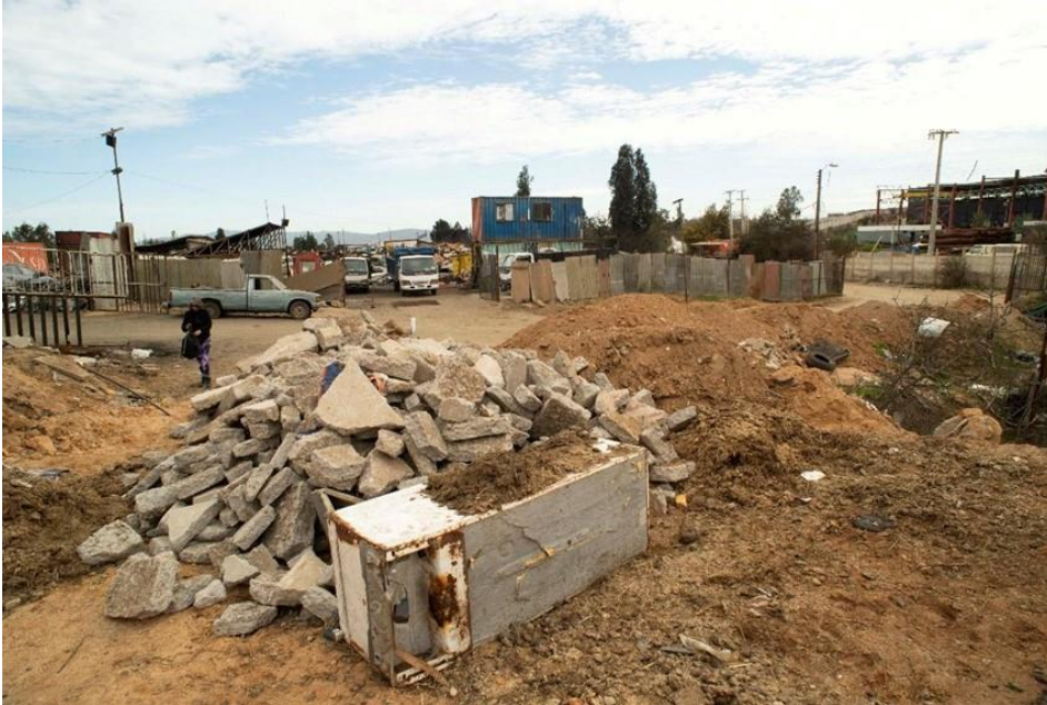
Fotografía 12: Vista de acopio de residuos de demolición y actividades acopio de chatarra, área sur de Villa Alemana, junto a límite urbano vigente
