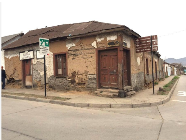
Fig. 16. Deterioro de la edificación / Barrio Guayacán Fuente: Fotografía Rodrigo Tapia C., 2016
