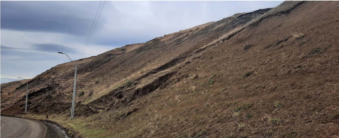
Figura 27 Deslizamiento ladera oriente Villa Cameron (camino de acceso)
