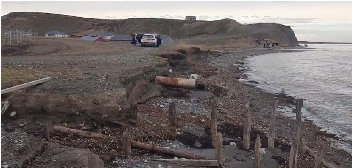
Figura 33 Sector susceptible socavamiento, sector Norte Villa Cameron
