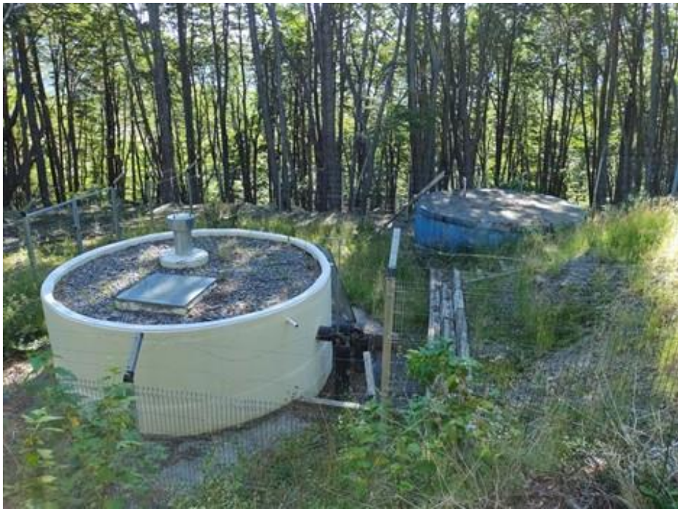
Figura 4.2. Estanques de regulación del APR Villa O'Higgins, localizados en Cerro Santiago.
