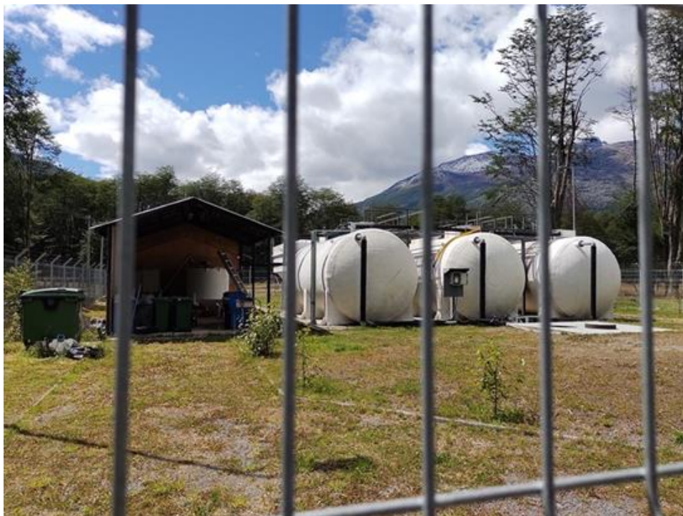
Figura 4.3. Reactores de la PTAS de Villa O'Higgins. Fuente: Estudio de Factibilidad Sanitaria, Pulso Spa. (2022).
