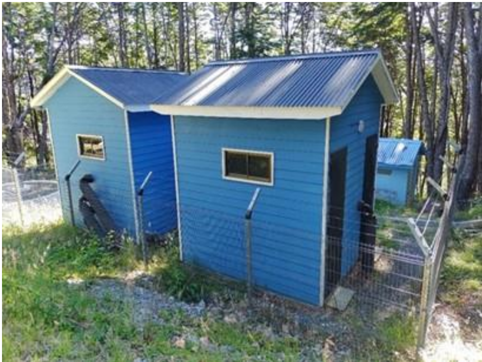
Figura 4.1. Instalaciones de filtración y cloración del APR Villa O'Higgins. Fuente: Estudio de Factibilidad Sanitaria, Pulso Spa. (2022).
