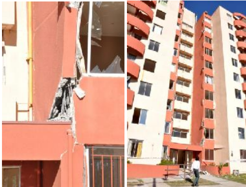
Edificios con fallas estructurales
