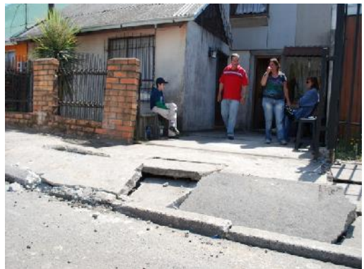
Destrucción infraestructura peatonal
