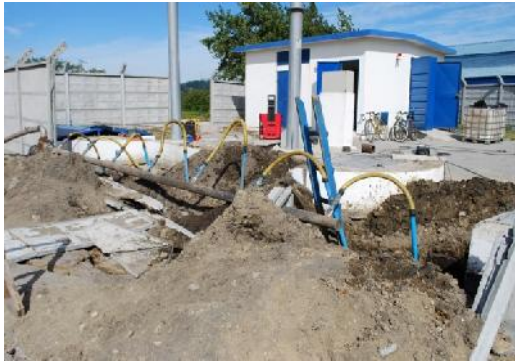
Tuberías rotas en Lenga
