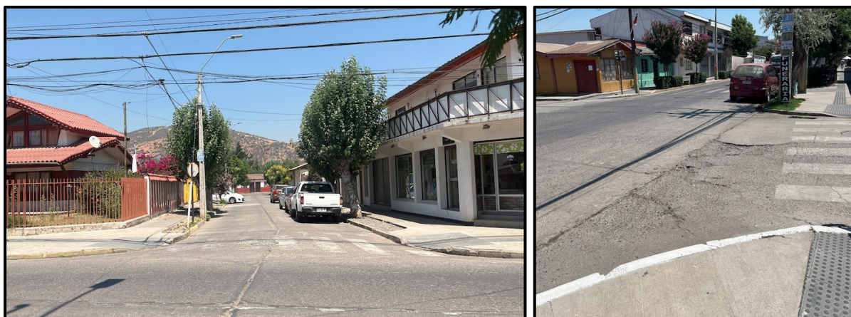
Figura 67. Esquina Félix Vicuña con Caupolicán Villouta, pavimento deteriorado
