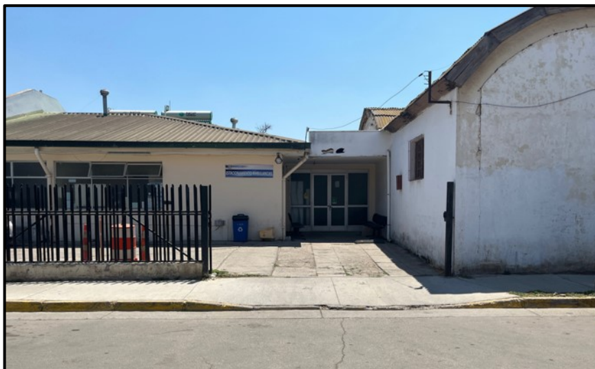
Figura 37. Situación pavimento deteriorado en acceso Cesfam Nogales
