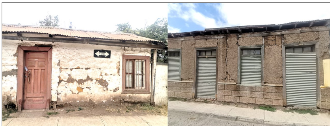
Figura 13. Viviendas de adobe en avanzado estado de deterioro
