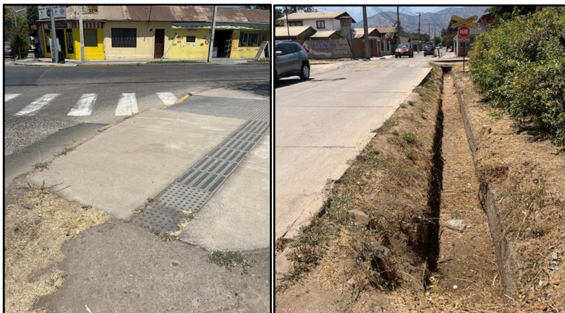
Figura 15. Situación veredas – Esquina Avda. José Cortes con Pedro Félix Vicuña y zanja de evacuación de aguas lluvias
