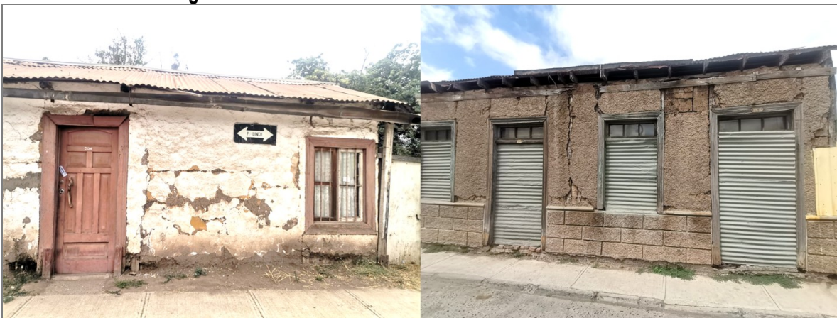
Fig. 25. Viviendas de adobe en avanzado estado de deterioro
