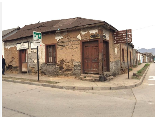
Fig. 9. Deterioro de la edificación / Barrio Guayacán Fuente: Fotografía Rodrigo Tapia C., 2016
