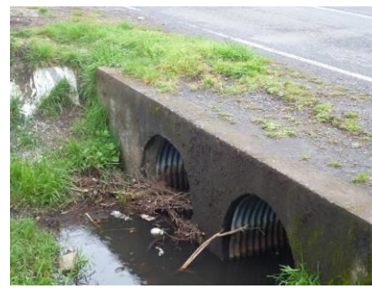
Figura N° 9. Alcantarilla de diámetro insuficiente para canalizar curso de agua.
