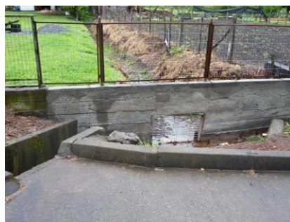
Figura N°33. Rendija que obtura canal de evacuación de aguas lluvias.
