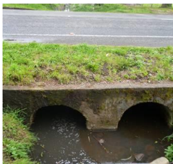
Figura N° 7. Alcantarilla de diámetro insuficiente para canalizar curso de agua.
