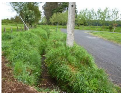
Figura N° 19. Canal artificial que conduce aguas lluvias a calle Anguita.
