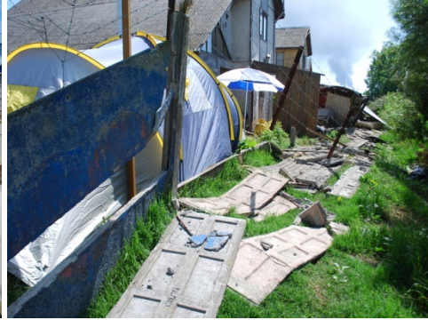
Daños en viviendas, muros de deslinde, etc.
