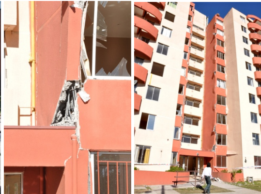
Edificios con fallas estructurales
