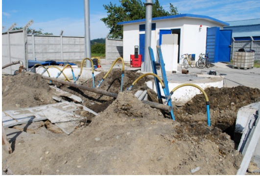
Tuberías rotas en Lengua
