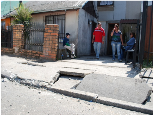
Destrucción infraestructura peatonal
