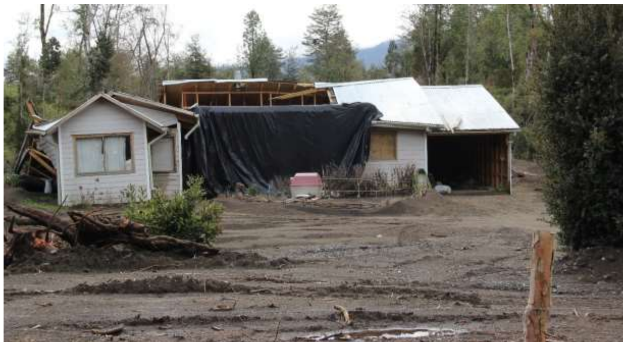
Figura 33 Colapso de techumbre por caída de cenizas – localidad de Ensenada
