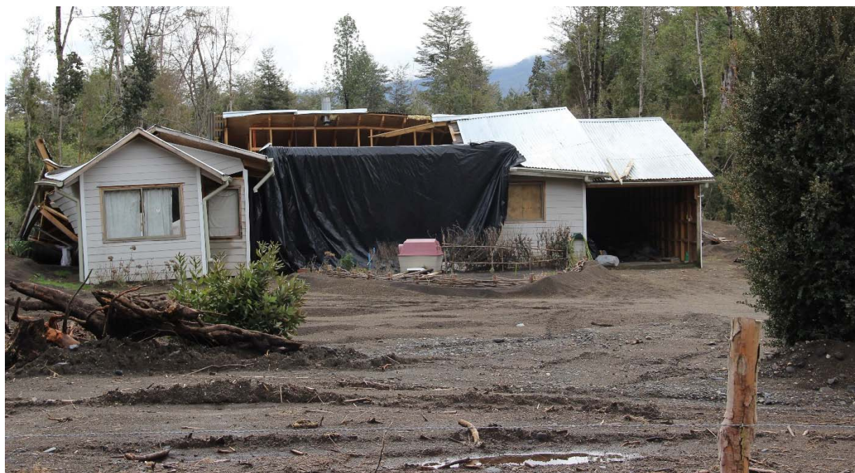
Figura 32 Colapso de techumbre por caída de cenizas – localidad de Ensenada
